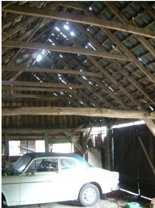
Ook in de wagenschuur en veldschuur regende het binnen net zo hard als buiten
