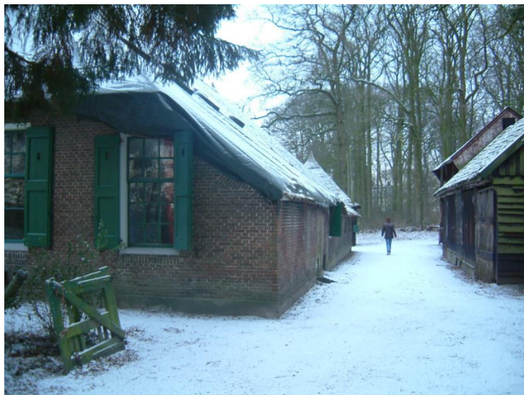
Bosweg 15 als kuilbult: vanaf eind 2002 werd het dak waterdicht gemaakt met zeil, dat op de plaats werd gehouden door autobanden.
